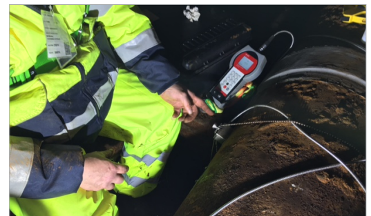
Der handliche KATflow 200 eignete sich hervorragend für die Testmessungen auf engem Raum unterhalb der Landebahn.
