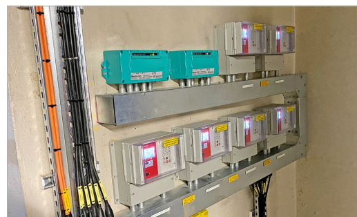
Sechs nichtinvasive Durchflussmesser KATflow 150 zur Festinstallation bei der Messung von Klärschlamm in einer Abwasseranlage in Südengland.
